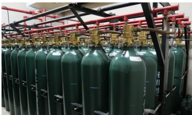
当館のガスボンベ貯蔵庫（132本）
