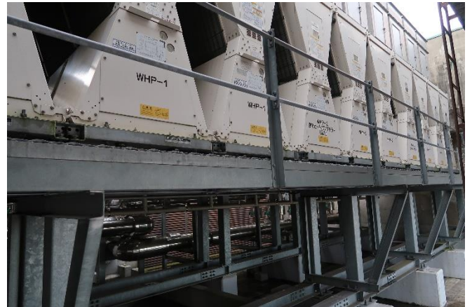
当館の中央熱源空調機器
