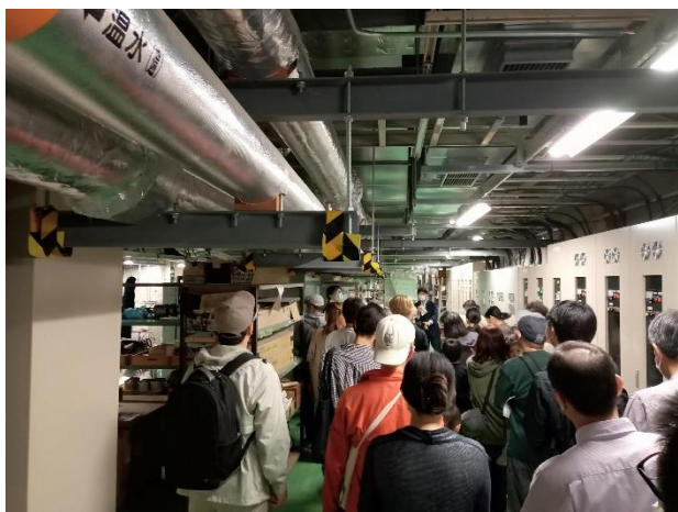
博物館裏方探検隊スペシャル 空調機械室
